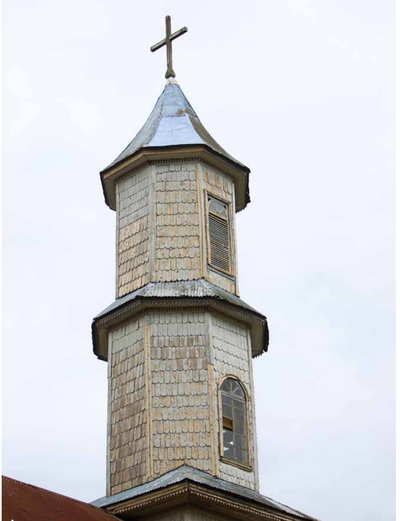
El deterioro de la Iglesia Nuestra Señora de los Dolores de Dalcahue antes de su restauración.
