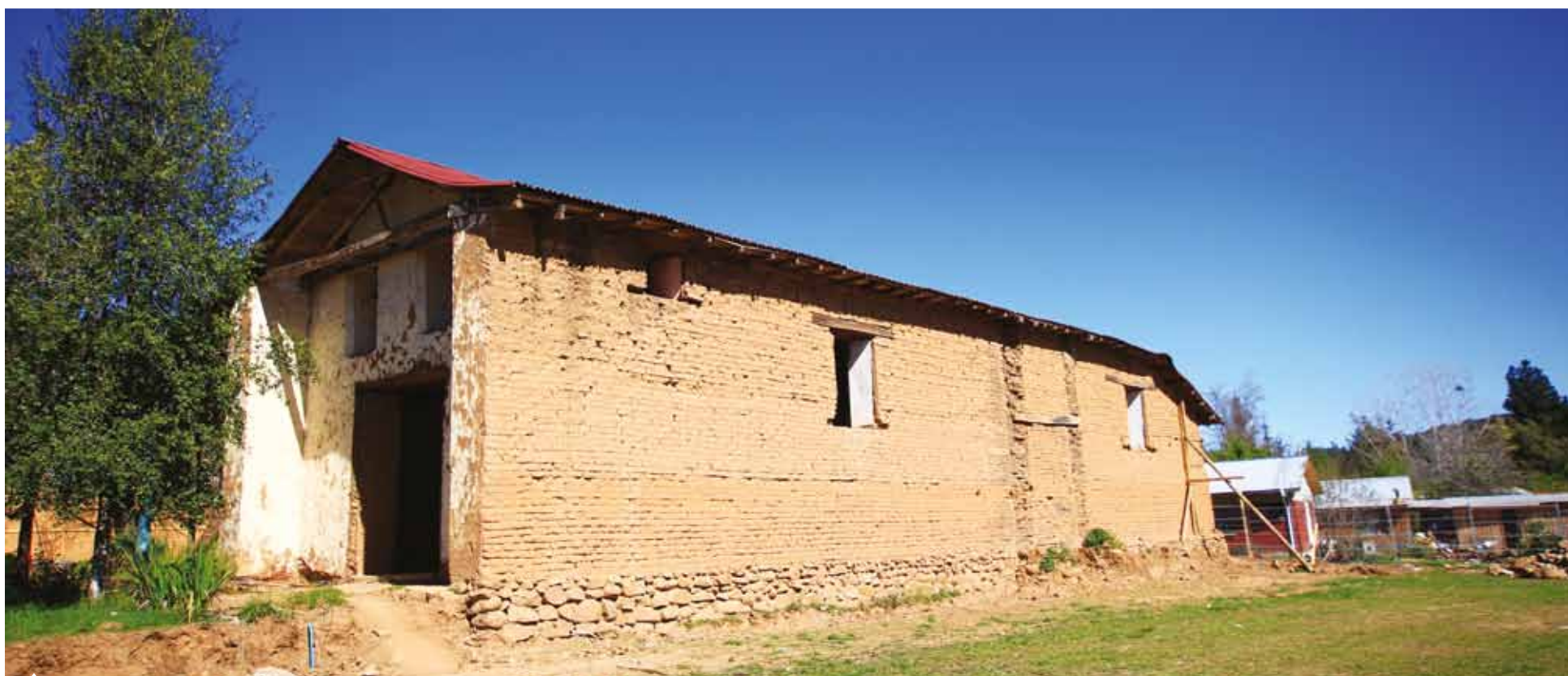
La estructura de adobe de la Capilla Nuestra Señora del Carmen de Batuco, presenta un gran deterioro.
